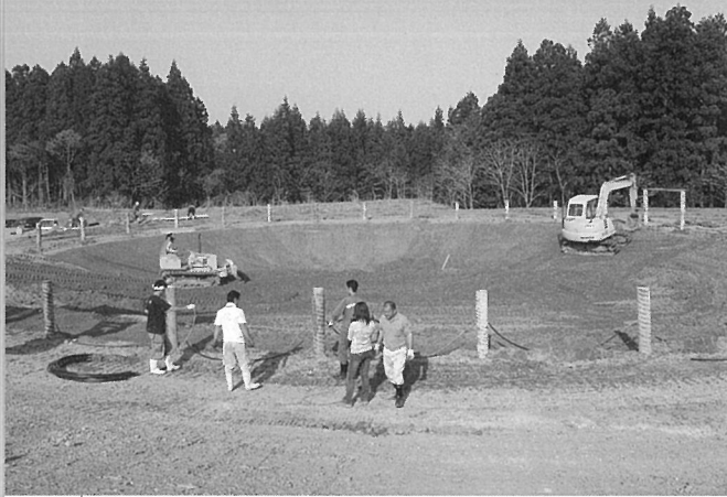
写真2 仮設闘牛場の建設。闘牛振興協議会会員が機材をもちより自分たちで作らあげた（2005年5月、筆者撮影）
